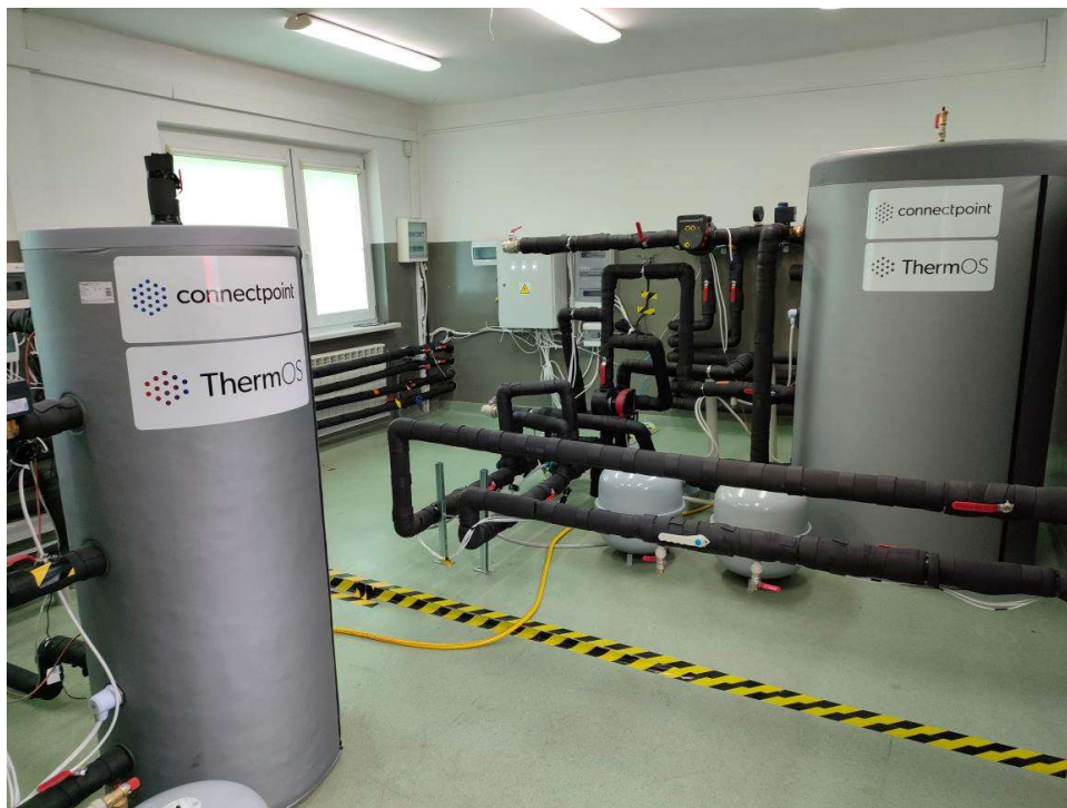
Zdjęcie maszynowni Prototypu Systemu
